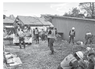
▲令和元年 東日本台風
